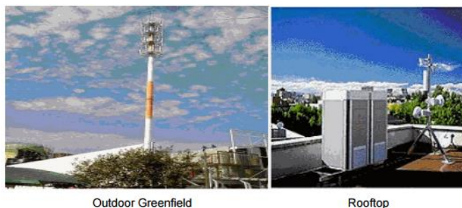
Figura 1 Estação ERB Outdoor e Roof Top.
